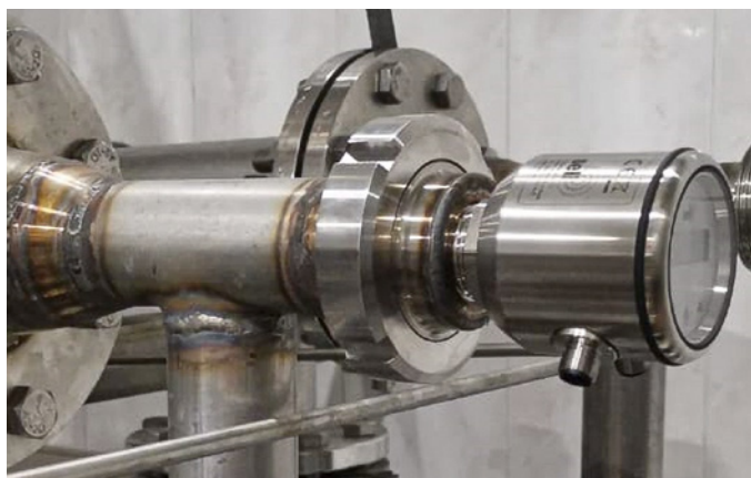
Рис. 6. Пример ошибочной установки датчика типа SLI03 в глухой части горизонтального трубопровода
